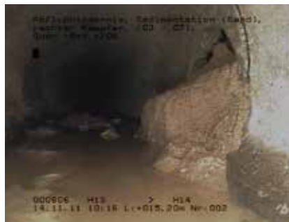
Schadstelle vor der Sanierung
