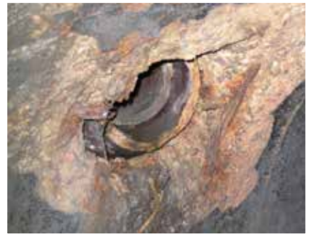
Stutzen vor der Sanierung
